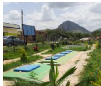
Fig: 10 KLD DEWATS
